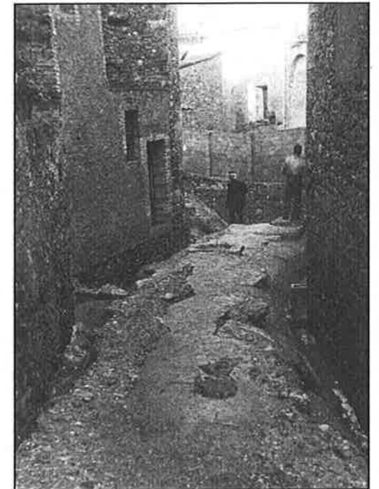
En aquestes dues fotografies podem veure el carrer Torrent Micó davant la casa de cal Miulas després del pas del torrent pel carrer, sense la calçada que fou arrossegada per l'aigua.
